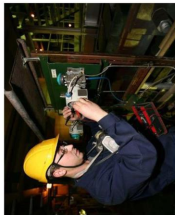
Ремонт и эксплуатация электротехнического оборудования
